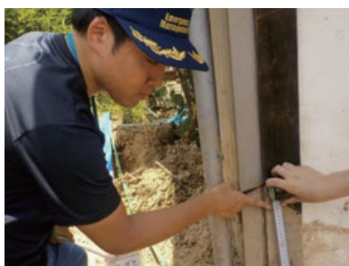
▲派遣した職員による被害状況の調査
