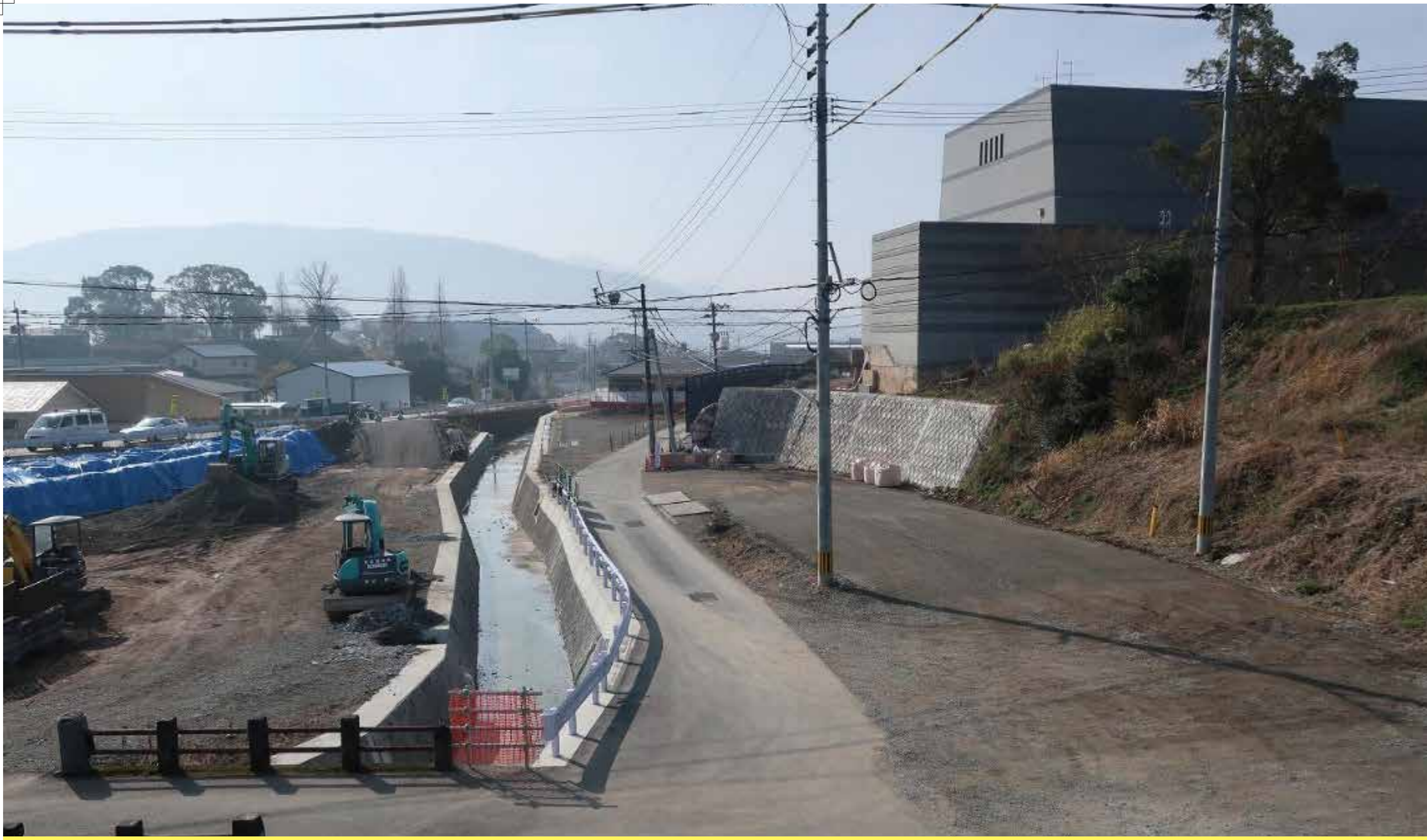
益城町寺迫住宅地被害 寺迫橋から文化会館を望む
