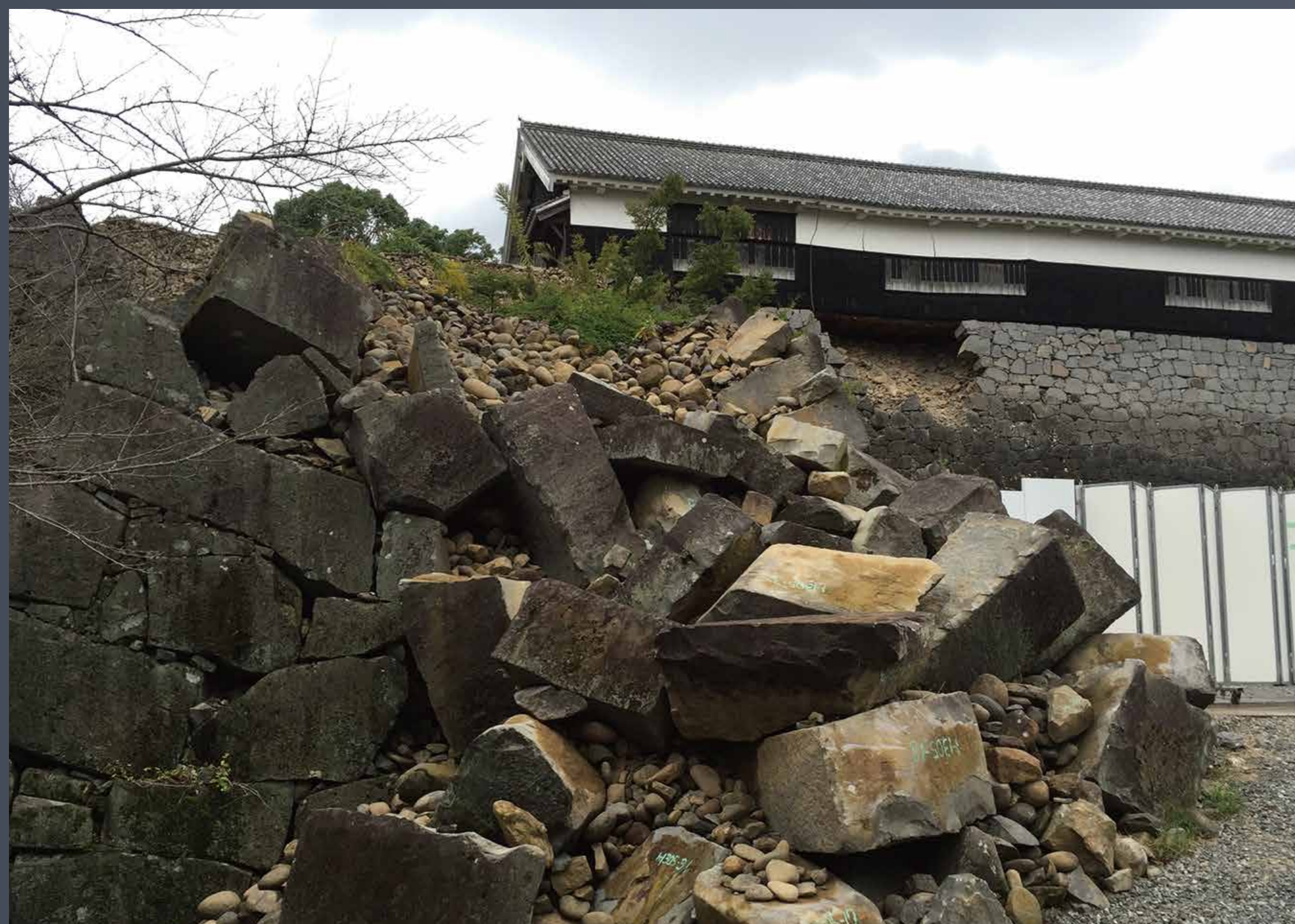
崩れてしまった熊本城の石垣。石材ひとつも文化財なので、全て番号を付番。
