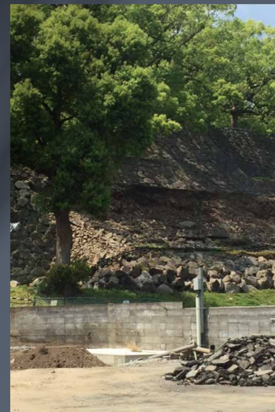
崩れてしまった熊本城の石垣
