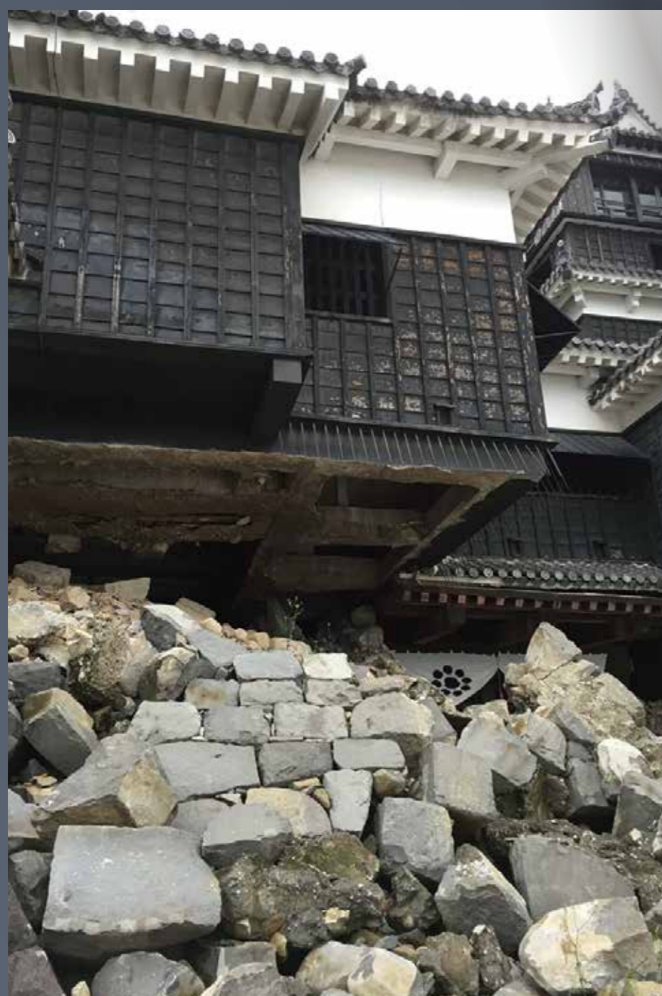
崩れてしまった熊本城の石垣
