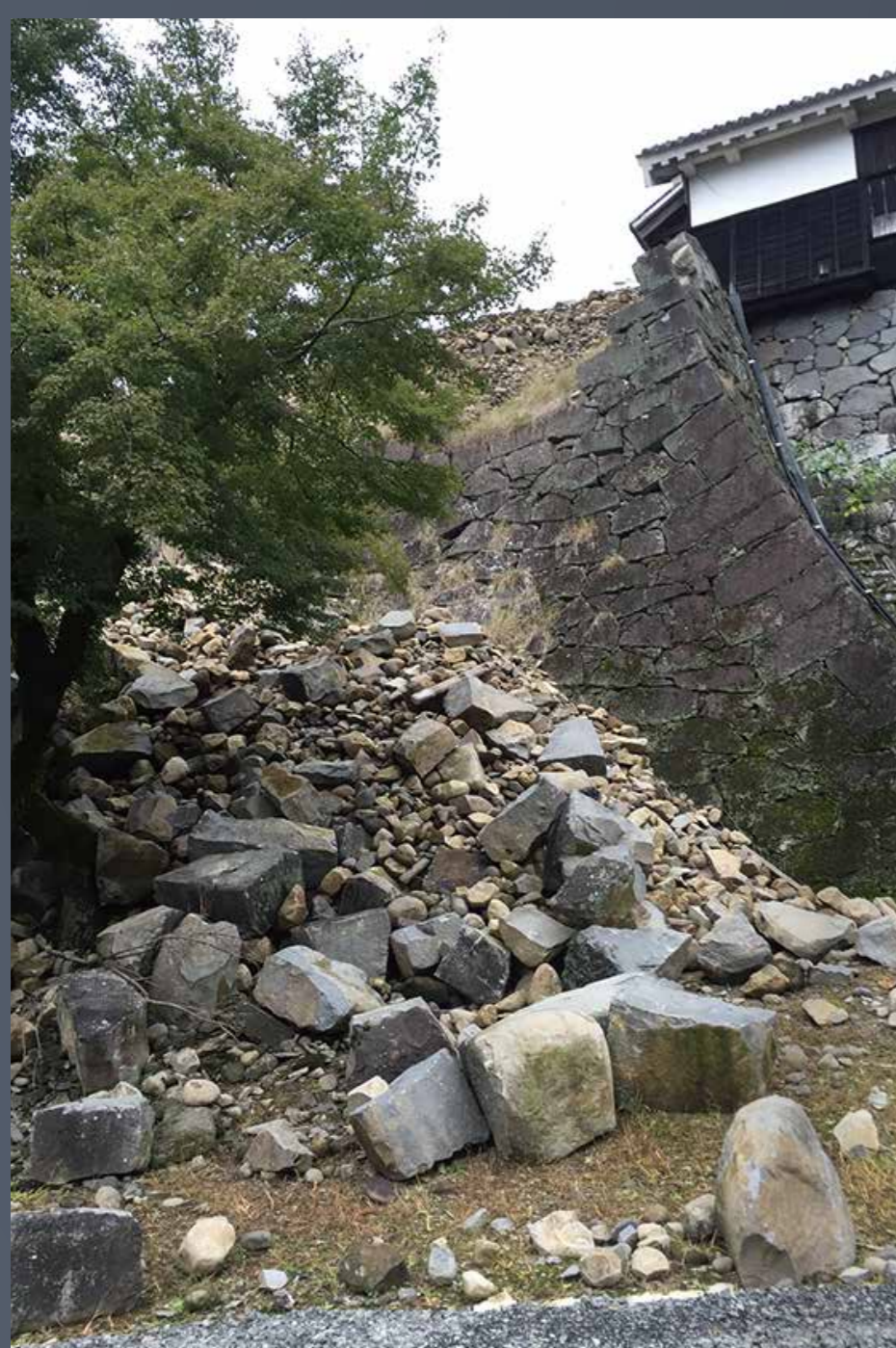
崩れてしまった熊本城の石垣
