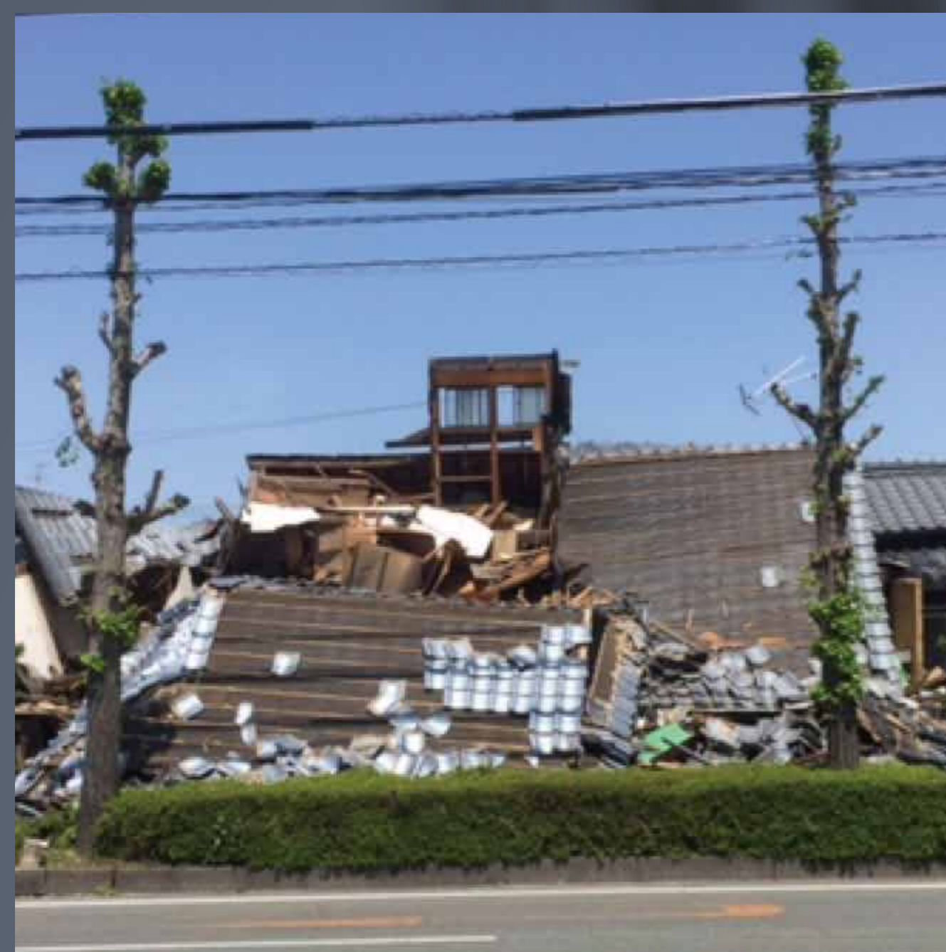
熊本市東区沿道の崩壊した住宅
