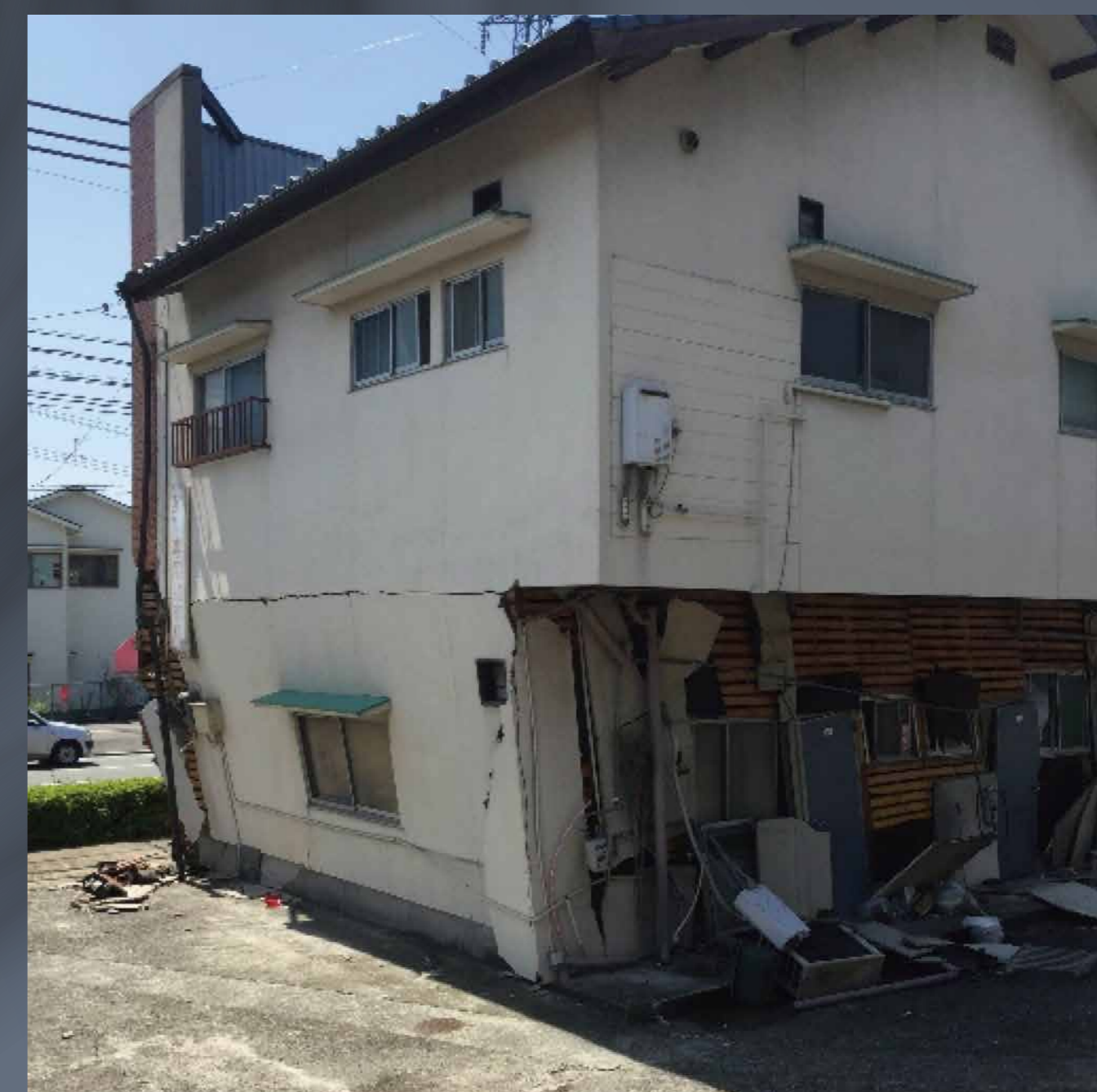
熊本市東区沿道の崩壊した住宅
