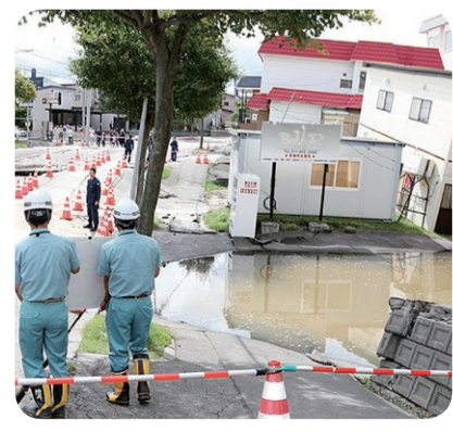
液状化の被害
